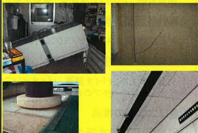
研究機器の倒壊、壁の亀裂、柱のずれ、天井崩落 (平成23年3月14日撮影)
